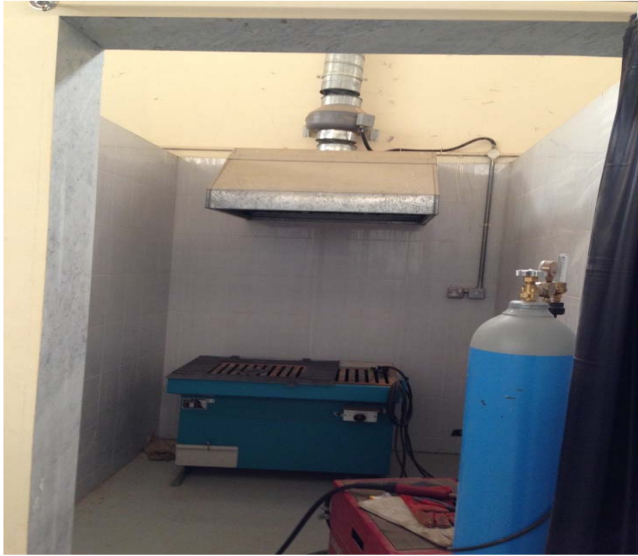
شكل ( 2 ) : يوضح أحد غرف اللحام في ورشة اللحام وعدم وجود طفاية حريق مجاورة.
